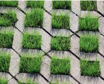
Niederschlagswasser muss nicht immer in die Kanalisation geleitet werden. Durchlässige Befestigungen ermöglichen das Versickern.
