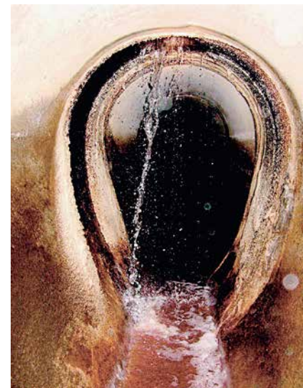
Kanalschäden: stark beschädigte Rohrwand durch kreuzende Versorgungsleitung (Bild oben), Grundwassereintritt bei undichtem Kanal (Bild unten)
