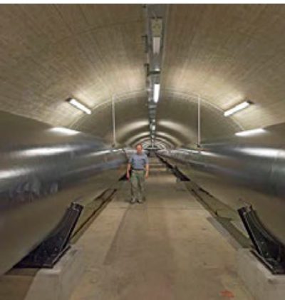
Zwei Stahlrohrleitungen in einem Gewölbestollen leiten das entnommene Wasser bis zum Krafthaus am Auslauf des Rothsees.
