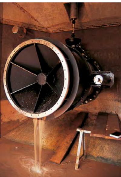
Ein Kegelstrahlschieber für die Wasserabgabe aus dem Rothsee
