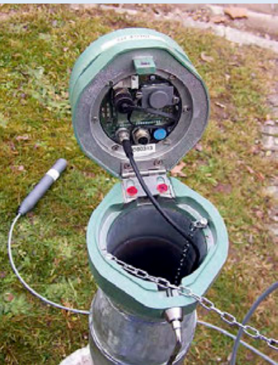
Über 300 Messeinrichtungen überwachen den Damm des Großen Brombachsees.
