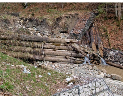
Überreste einer zerstörten Holzsperrre – was tun?
