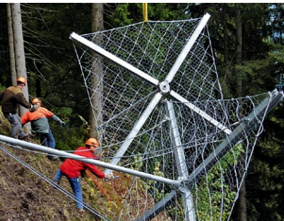
Moderne Variante einer Stützverbauung, sogenannte „Umbrellas“ (Regenschirme) in Bad Hindelang, Auelesrinne
