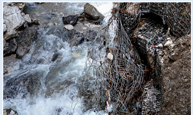
Starker Geschiebetransport: Zerstörung von Gabionen
