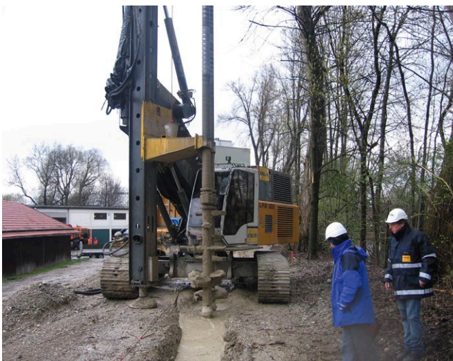
Oben: Überströmung einer Dichtwand an der Iller in Fischen während des Hochwassers 2005; Unten: Einbau einer Dichtwand als tiefreichende Bodenvermörtelung (Hochwasserschutz Mangfall)
