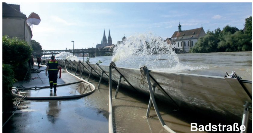
Abb. 27: Mobiles Hochwasserschutzsystem; Hochwasser am 04. Juni 2013 am Pegel Eiserne Brücke
