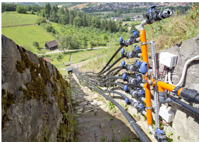
Abb. 34: Leitungssystem der Bewässerungsanlage
