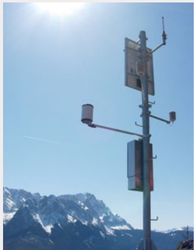
Abbildung 1: Eine von vier neu installierten Klimastationen
