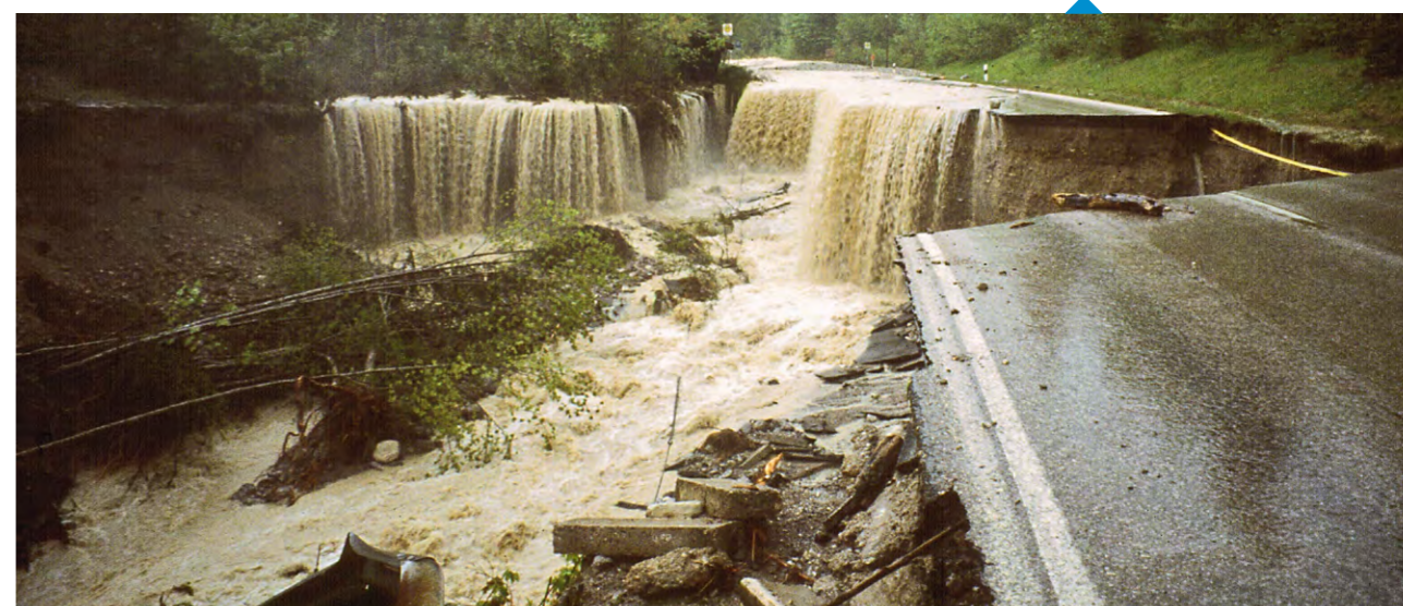
Schäden an der B 307 nach dem Pfingsthochwasser 1999
