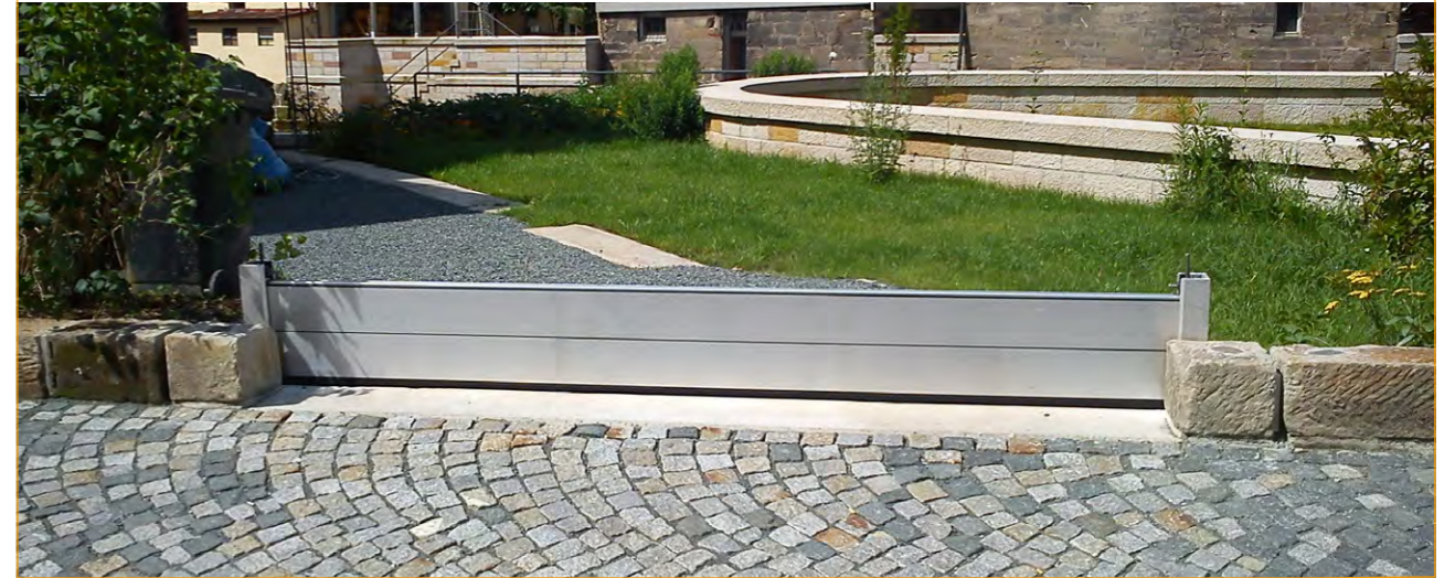
Hochwasserschutz mit mobilen Elementen an einer Zufahrt
