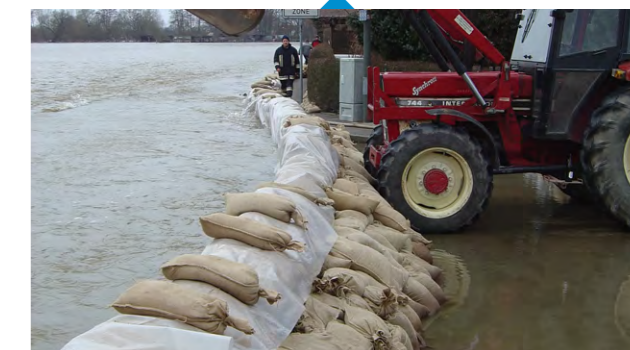
Sandsackbarriere bei Paarhochwasser im März 2006 in Baar-Ebenhausen
