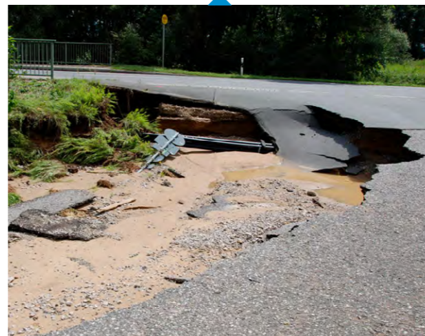
Zerstörte Straßen nach Starkregen im Landkreis Forchheim 2007
