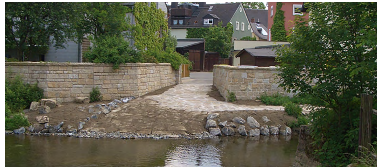
Der Hochwasserschutz in Schwarzenbach schützt vor einem 100-jährlichen Hochwasser der Saale (bei noch höheren, extremen Wassermengen wären die Wohngebiete hinter der Mauer jedoch gefährdet)
