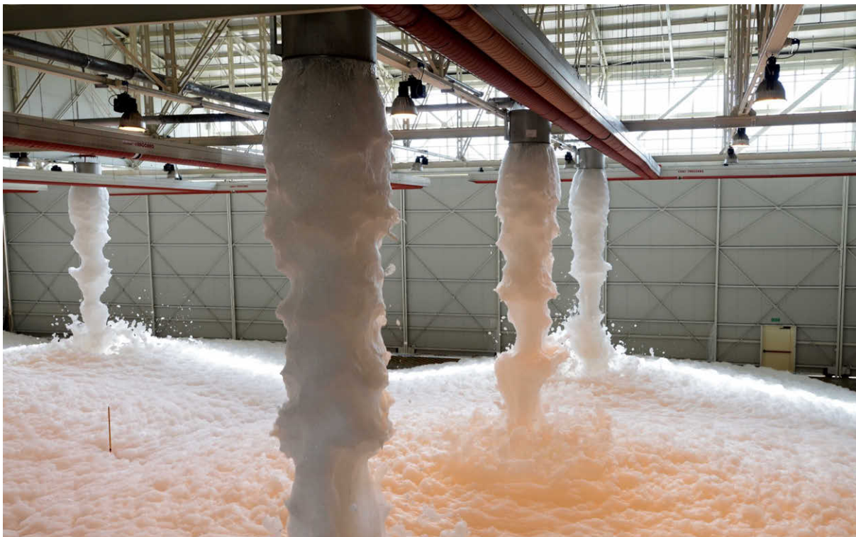
Abb. 32: In zahlreichen stationären Löschanlagen sind wegen der vorhandenen Brandrisiken Schaummittel enthalten.
