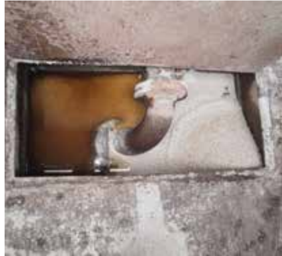
Düngemittelrückstände im Pumpensumpf → hohe Schmutzstoffkonzentration im IBC → Slops sind getrennt zu entsorgen
