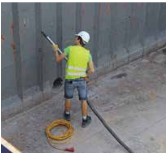
Industriesauger bei Spanten
