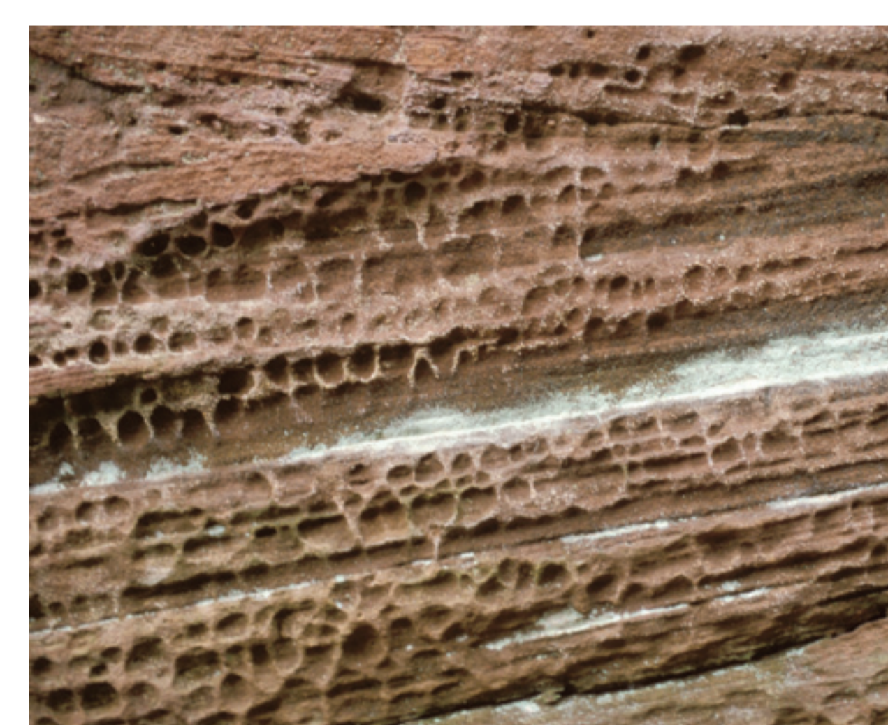
"Sandlöcher" und Wabenverwitterung sind auf unterschiedliche, kleinräumig wechselnde Verfestigung zurückzuführen.
