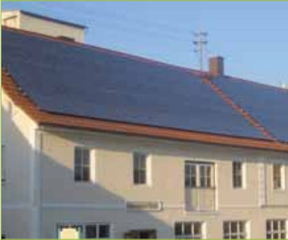
Abb. 3-36 Photovoltaik auf der Dachschräge
