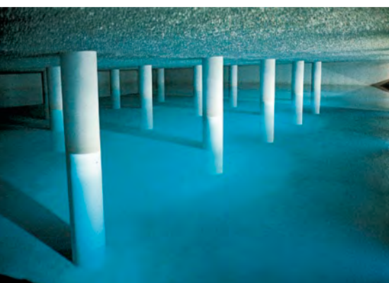
Trinkwasserspeicher einer Wasserversorgung
