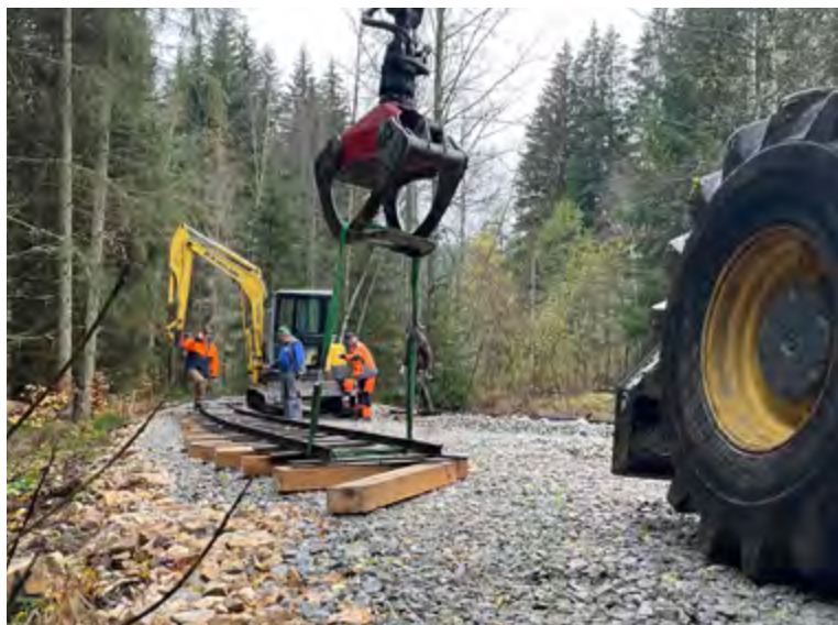
In Zusammenarbeit mit der Sektion Mauth des Wald-Vereins sanierten Mitarbeiter der Nationalparkverwaltung das einstige Waldbahnende im Oberen Reschbachtal.
