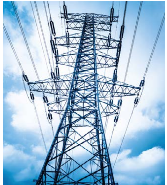
Abbildung 15: Höchstspannungstrassen werden häufig als Freileitungen angelegt.
