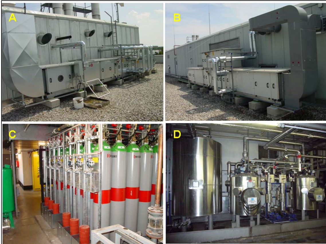
Abbildung 4.9: Technische Sicherheitsmaßnahmen. A: Lüftungsanlage (Zuluft). B: Lüftungsanlage (Abluft). C: Argonlöschanlage. D: Thermische Abwassersterilisationsanlage.
