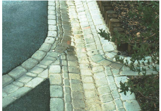
Abb. 20: Offene Ableitungen und -gräben Offene Sammlung und Ableitung wird Teil des Frei- und Straßenraums. Hydraulische Leistung, Verkehrssicherheit (Überfahrbarkeit) und Wartungsaufwand bestimmen die Gestaltung.
