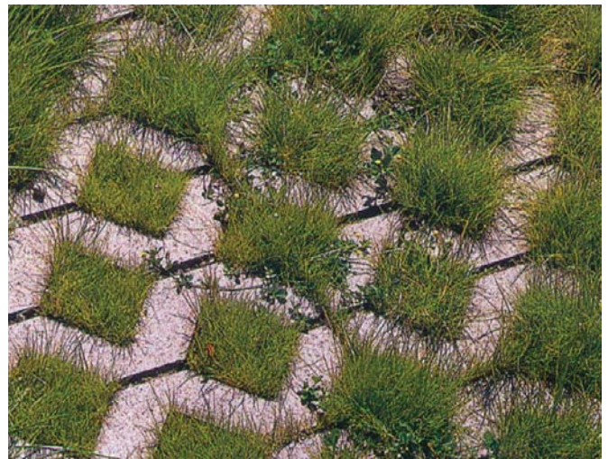
Abb. 29: Rasengittersteine auf einer Feuerwehrezufahrt
