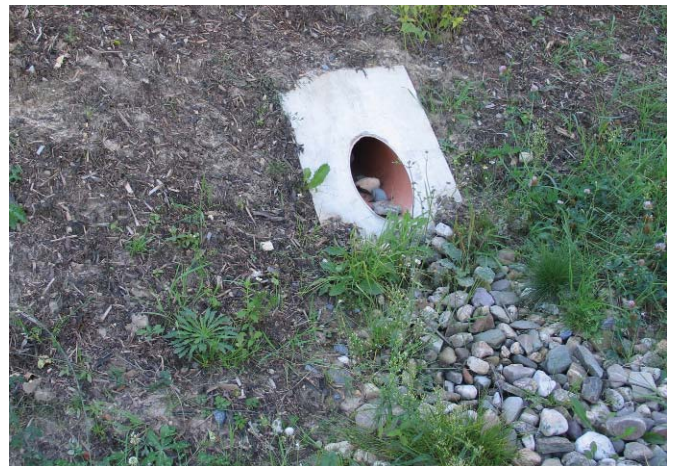
Abb. 24: Dezentrale Einleitung Bei fehlender Versickerungsmöglichkeit kann der gedrosselte Regenwasserabfluss, um die Reinigungswirkung zu steigern, über einen bewachsenen Graben in ein Oberflächengewässer geleitet werden.
