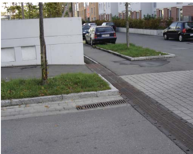
Abb. 43: Überleitung in einer abgedeckten Kastenrinne an Straßenkreuzungen
