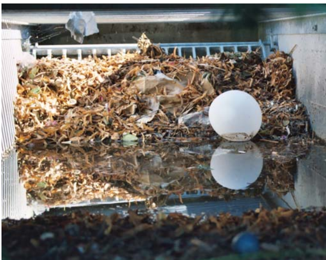
Abb. 56: Einlaufrechen vor Verrohrung - ein notwendiger und wirkungsvoller Grobstoffrückhalt bei Abflüssen von Straßen und Außengebieten.
