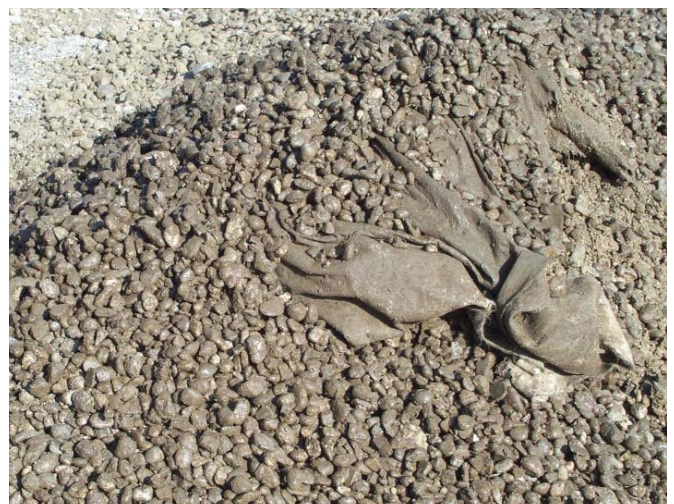
Abb. 65: Versickern ist hier leider nicht mehr möglich: Ein verschlammtes, undurchlässiges Rigolenvlies nach wenigen Betriebsjahren.
