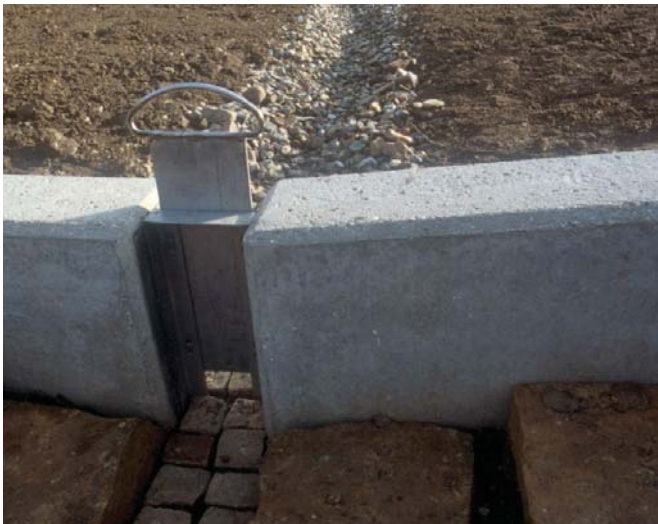
Abb. 47: Abflußdrossel - sichtbar, verständlich, leicht zu warten
