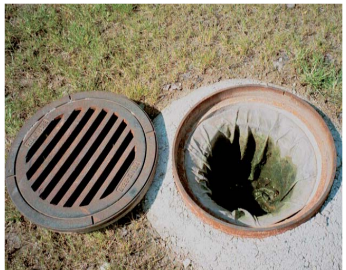
Abb. 57: Überlaufschacht mit Filtersack - hohe Feinstoffrückhaltung, jedoch aufwändiger in der Wartung.
