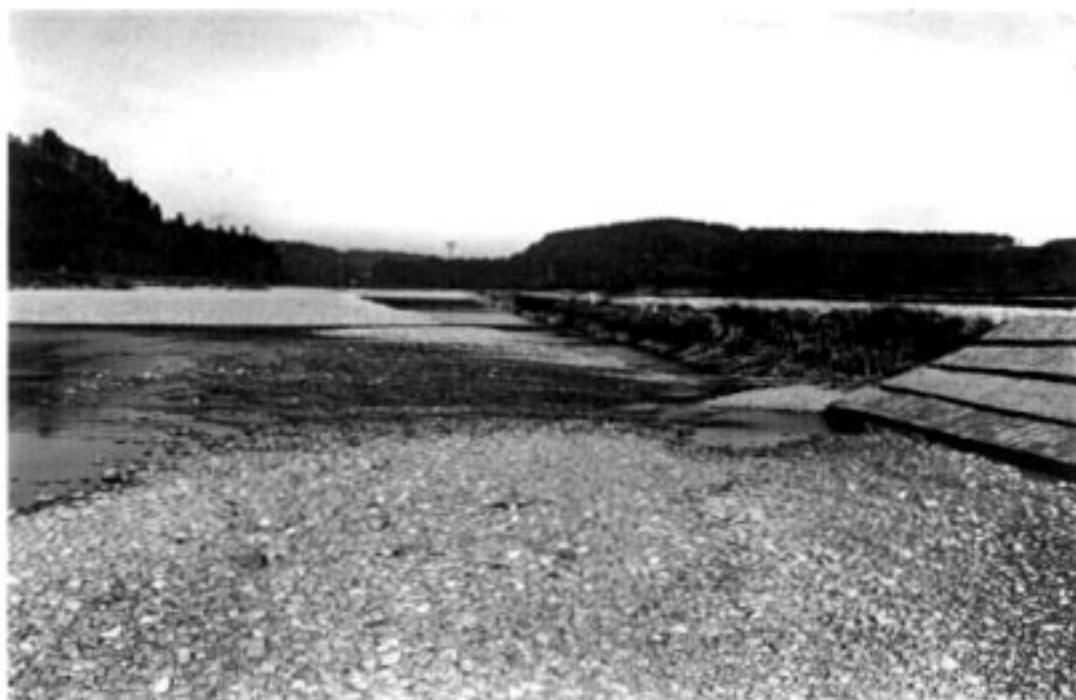
Von Fkm 167.7 flußabwärts, stark angegriffenes Ufer im Queranfall, 14.11.28
