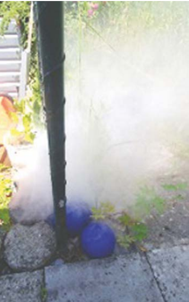
Abb. 6: Signalnebel-Untersuchung zur Feststellung von Fehlschlüssen
