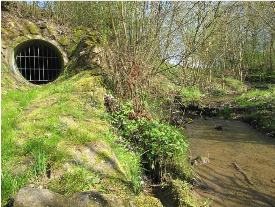
Abb. 43: Einleitungsstelle einer Mischwasserentlastung
