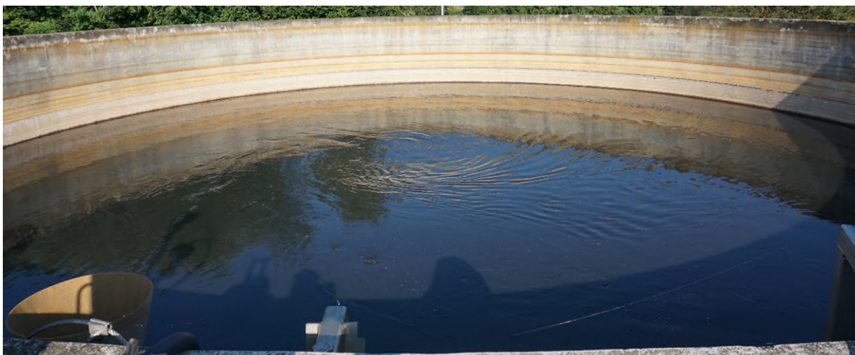
Abb. 10: Schlammwasserbehälter nach der Entwässerung
