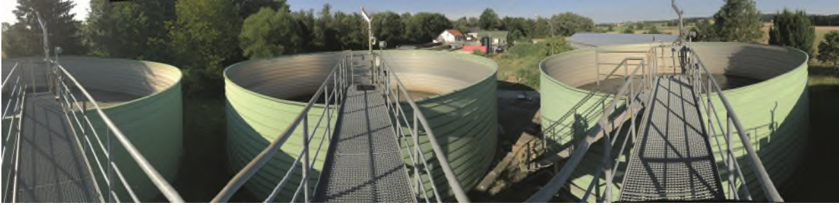
Abb. 6: Schlammstapel- und Schlammwasserbehälter steigern die Entsorgungssicherheit und Betriebsstabilität
