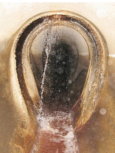
Abb. 13: Fremdwassereintritt durch undichte Rohrverbindung
