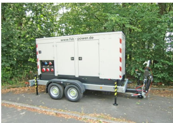
Abb. 26: Mobile Netzersatzanlage (100 kVA)
