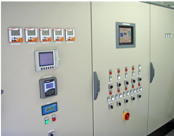
Abb. 87: Leittechnik einer Wasserversorgungsanlage
