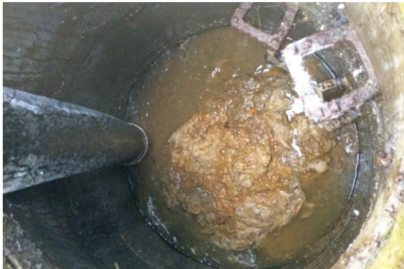
Abb. 10: Hoher Feststoffanteil in einem Pumpensumpf
