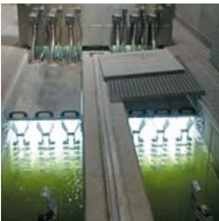
▲ Die Kläranlage Lenggries an der Isar wurde zusätzlich mit einer UV-Bestrahlungsanlage zur Reduktion der Keimbelastung ausgerüstet.
