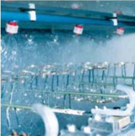
▲ „Washstraße“ einer modernen Galvanikanlage. Dank Wasser sparender Technologien konnte die Industrie ihren Wasserverbrauch in den letzten Jahren stark reduzieren.
