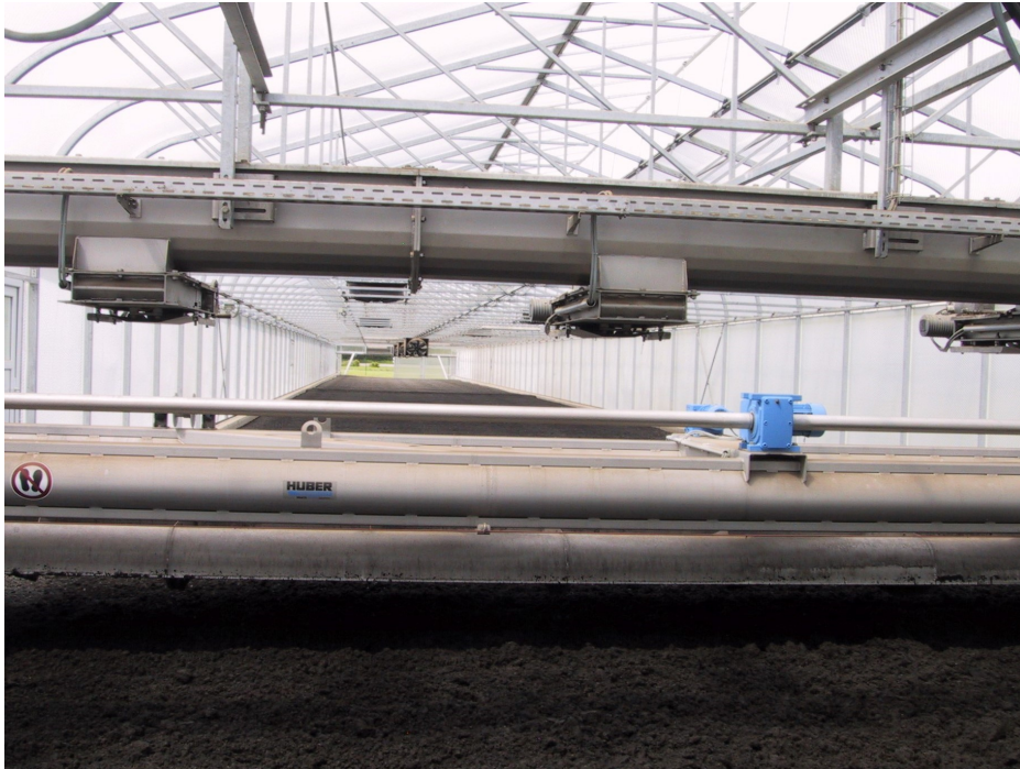
Abb. 12: Solare Klärschlamm- trocknung auf der Klär- anlage des AZV Penzing-Weil
