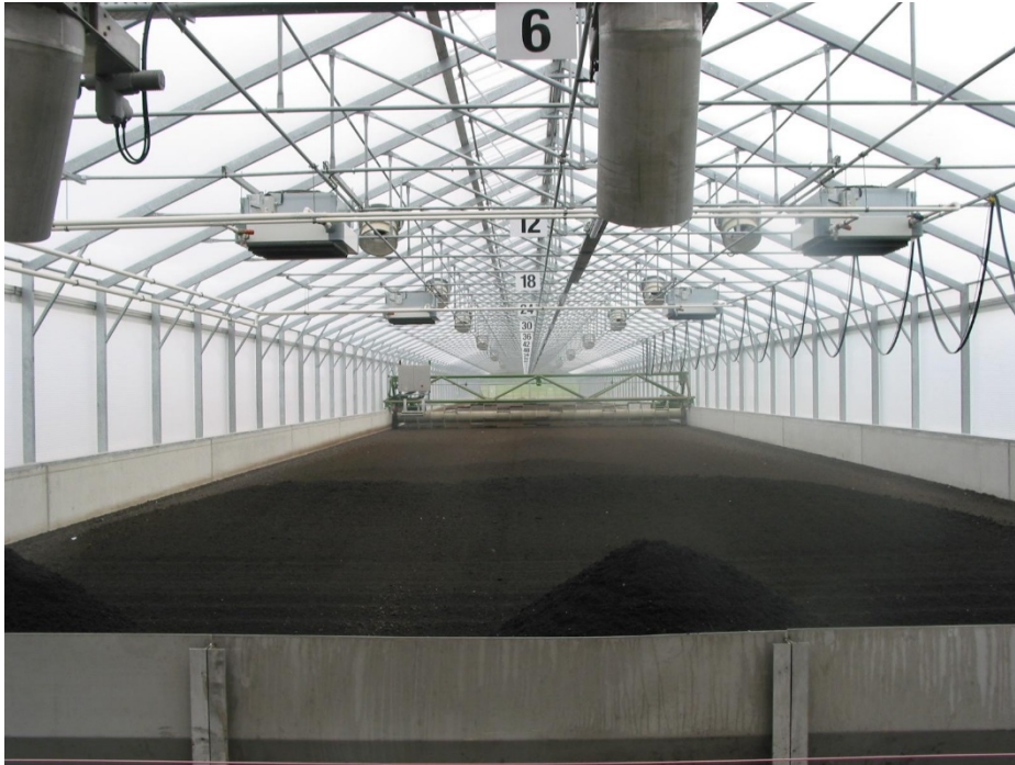
Abb. 12: Solare Klärschlamm- trocknung auf der Klär- anlage Main-Mud
