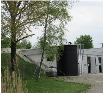
Abb. 6: Anlage mit Fällmitteltank
