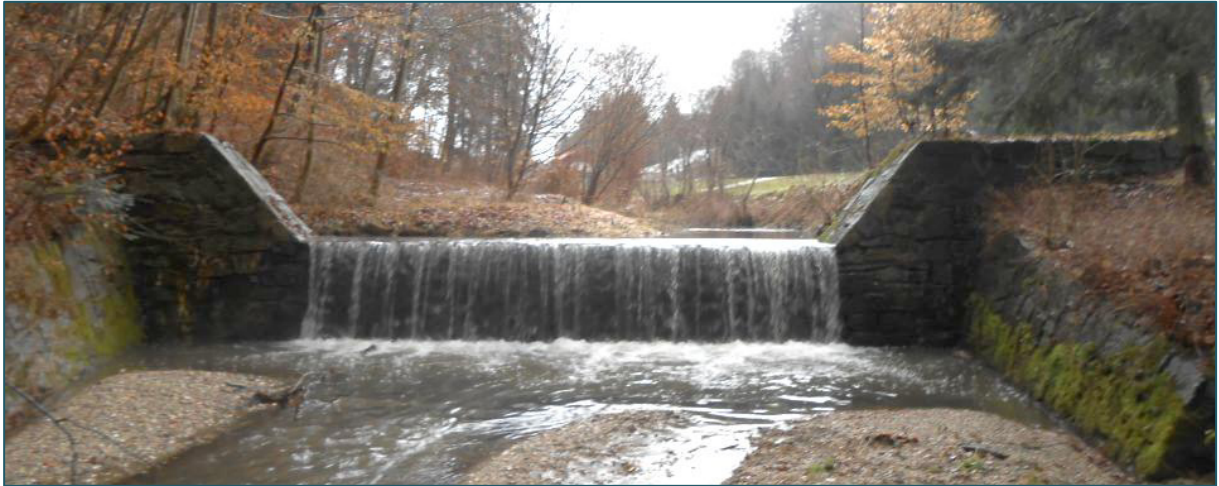
Abb. 77: Foto eines Absturzes im Gewässerlauf
