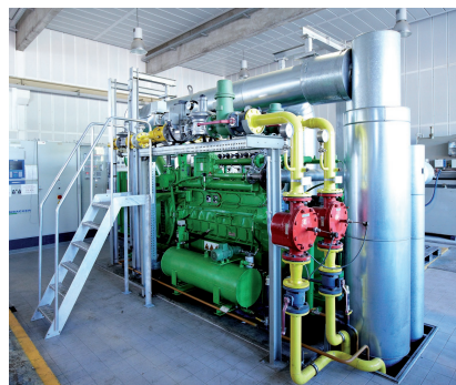
Abb. 3: Die Kläranlage als Kraftwerk: Blockheizkraftwerk zur Energieerzeugung (links)
