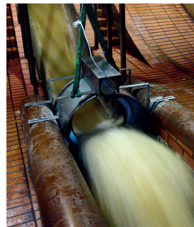
Abb. 15: Prototyp der Abwasserturbine im Kanalnetz
