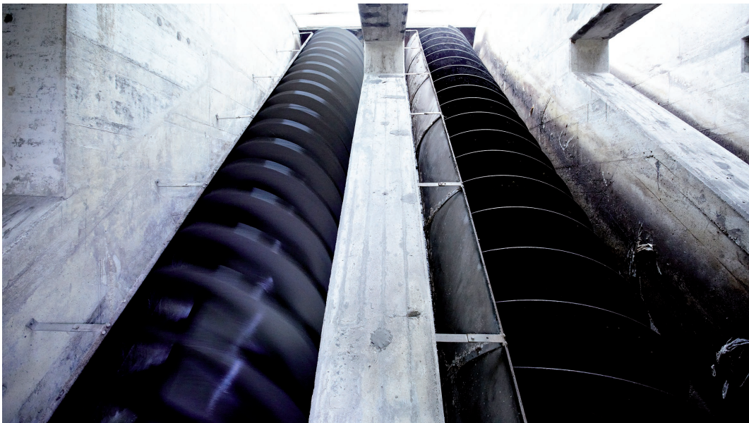
Abb. 31: Zulaufhebwerk einer Kläranlage
