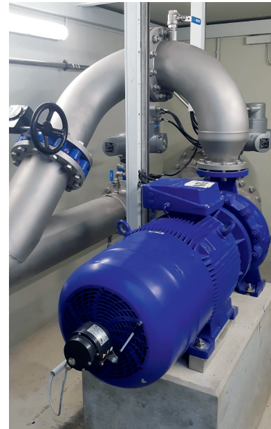
Abb. 14: Rückwärtslaufende Abwasserpumpe als Turbine im Ablauf der Kläranlage Betzenstein/Plech
