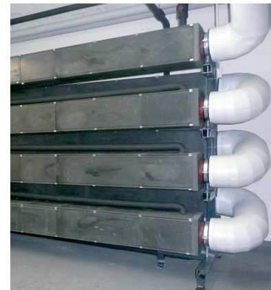
Abb. 6: Wärmetauscher im Keller eines Berliner Hochhauses
