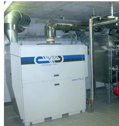
Abb. 20: Mikrogas-Turbine zur Eigenstromerzeugung
