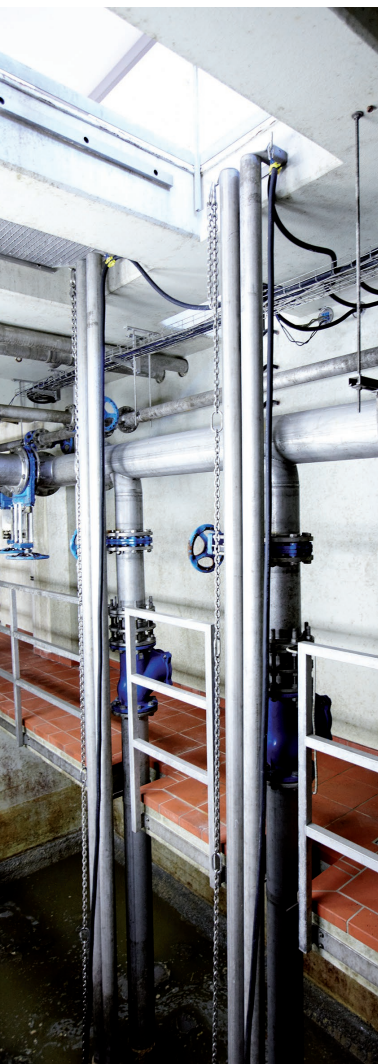
Abb. 27: Pumpwerk mit Tauchmotorpumpen
