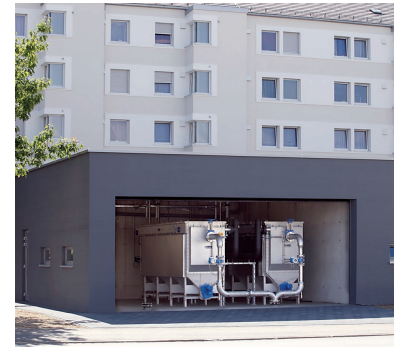
Abb. 12: Heizungsgebäude mit Bypass-Wärmetauscher für die Wohnsiedlung in Straubing
