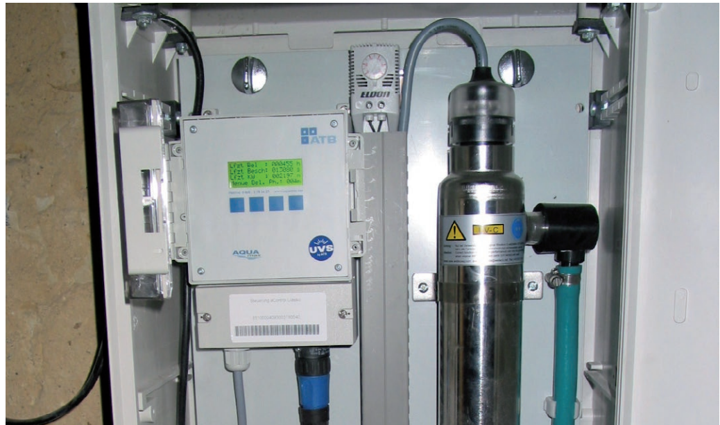
Abb. 15: UV-Lampe im Steuer- kasten der Kleinkläranlage (Zylinder rechts)
