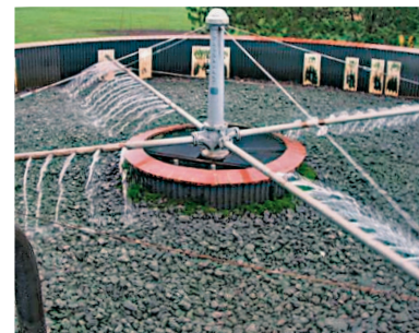
Tropfkörper der Kläranlage Horgau (4.500 EW Ausbaugröße)
