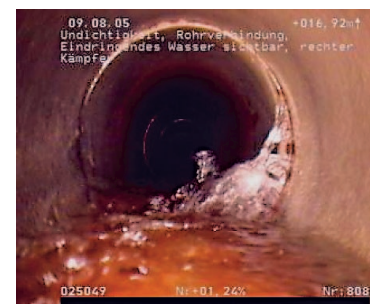
Fremdwasser im Kanal
