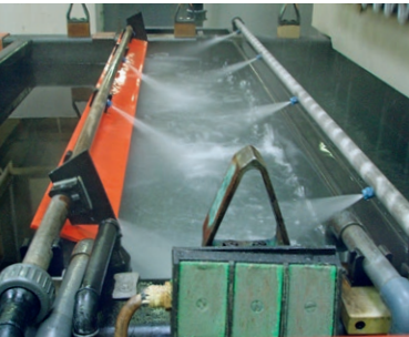
Spülwassereinrichtung in einem Galvanikbetrieb
