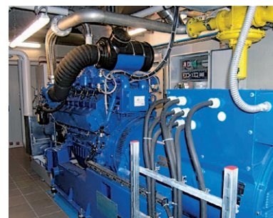
Nutzung von Faulgas auf einer Kläranlage, zur Energiegewinnung durch ein Blockheizkraftwerk
