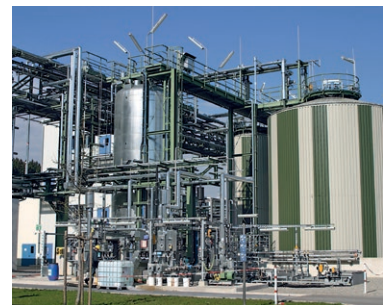
Abwasserbehandlungsanlage im Chemiepark Trostberg
