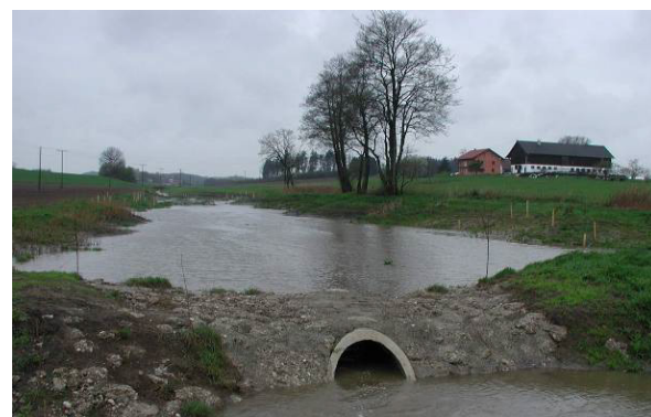
Danach: Hochwasserrückhalt in der Fläche auf ca. 4.000 m 2 ! (Bauabschnitt III). (Foto: T. Hofmann)
