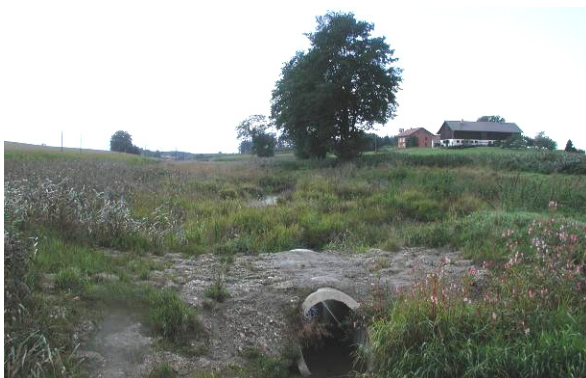
Danach: Strukturreicher Bach durch flächigen Vorlandabtrag. Die Überfahrt dient als „Hochwasserbremse“ (Bauabschnitt III). (Foto: T. Hofmann)
