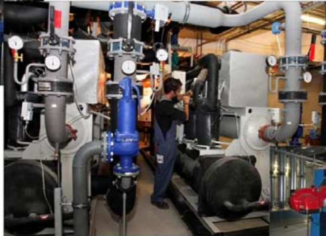
2 Wärmepumpen á 640 kW
