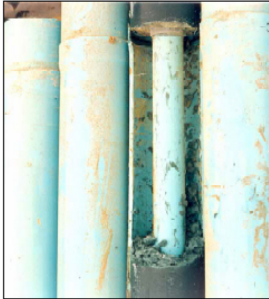
Füllsäulenabriss aufgrund mangelhafter Suspensionsstabilität
