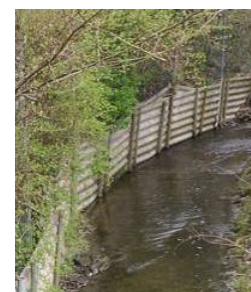
▲ Unsachgemäßer Gewässerausbau beeinträchtigt Lebensräume und das Ortsbild.
