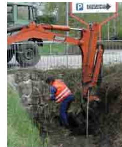
▲ Gefahrenstellen gewis- senhaft unterhalten!
