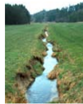
▲ Vorher: Sohl- und Ufererosion beschleunigen den Hochwasserabfluss.
