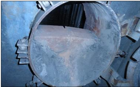
Abb. 13: Zugangsluke Feuerungs- bereich
