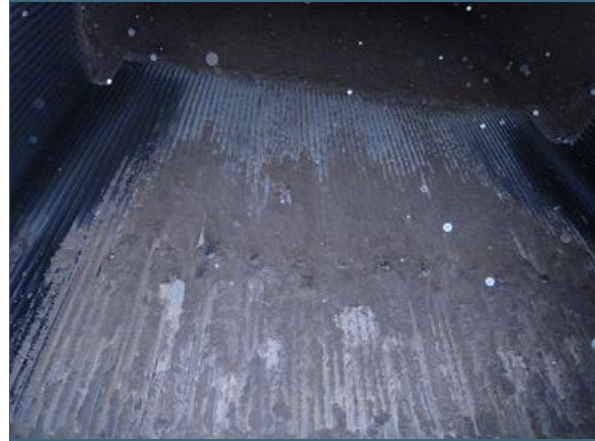
Abb. 16: Kessel - Wand Einstiegsseite
