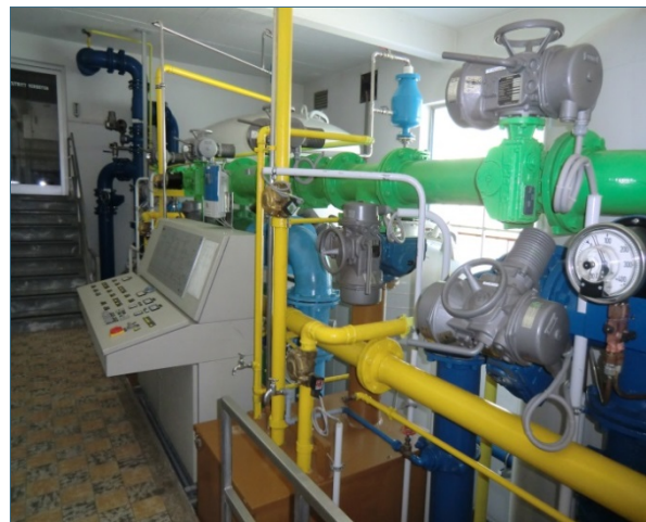
Abb. 23: Schaltpult zur Prozessregulierung, z. B. zur Rückspülung
