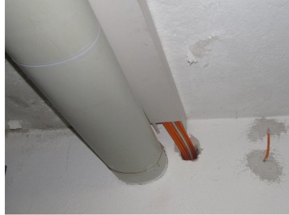
Abb. 18: Nicht abgedichtete Durchführung mit EDV-Leitungen.
