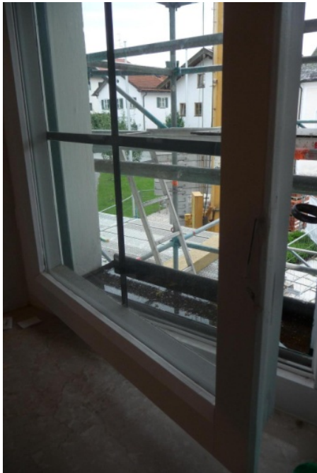
Abb. 31: Erneutes Fenster mit einzelner Außenscheibe und dahinterliegender Zweifachverglasung.
