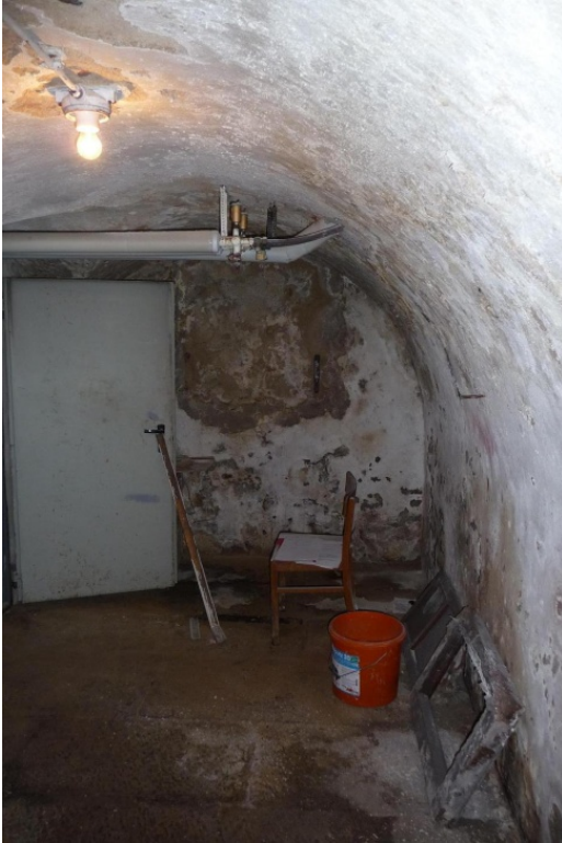
Abb. 11: KG Heizvorraum mit Natursteinplatten.
