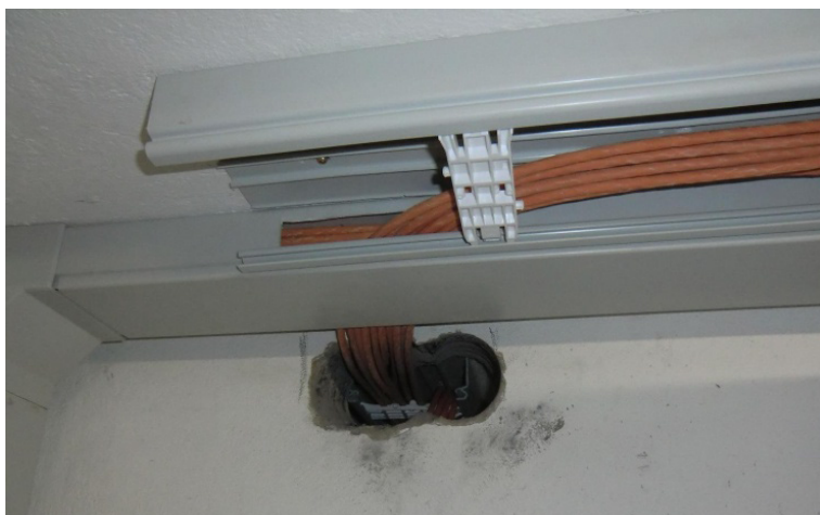
Abb. 38: Offene EDV-Kabeldurchgänge im Keller.
