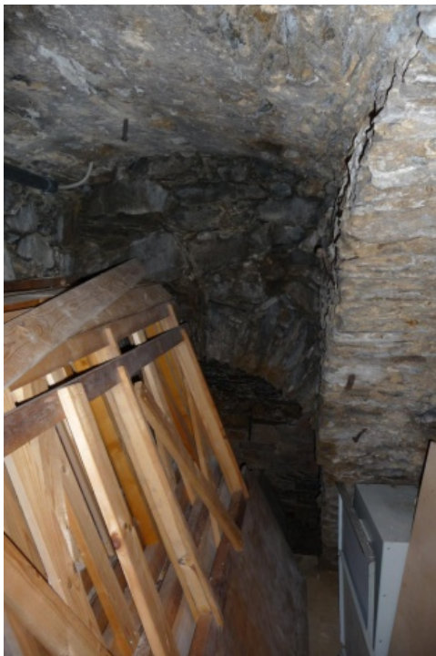
Abb. 15: Undichtes Mauerwerk, offener Kellerboden: vermutlich Radon-Haupteintrittspfad.
