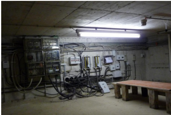
Abb. 34: Kabeldurchführung nach außen in KG Nutzraum 1.
