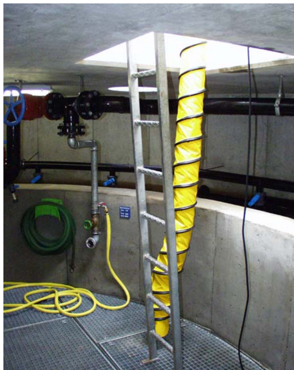
Abbildung 9.2: Mobiles Belüftungssystem im Einsatz in einer unterirdischen Aufbereitungsanlage (Innenansicht) im Wasserversorgungsunternehmen Nr. 5122.
