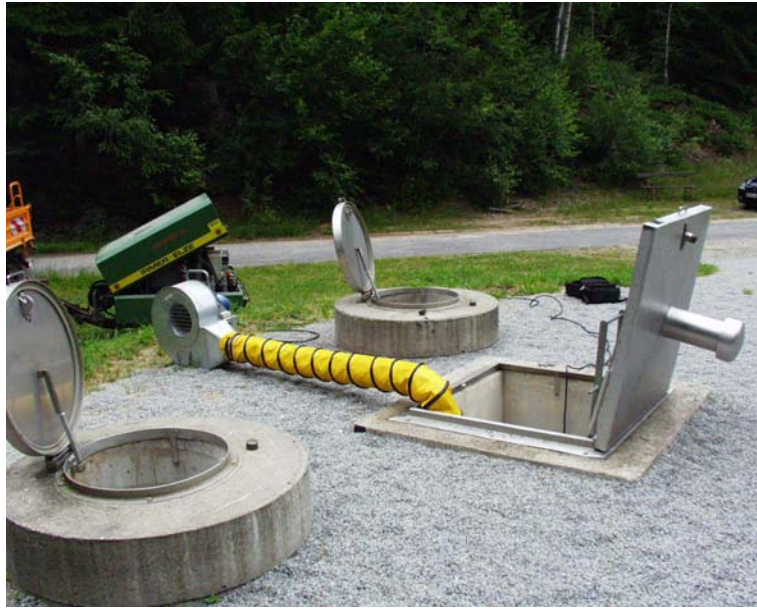
Abbildung 9.1: Mobiles Belüftungssystem im Einsatz in einer unterirdischen Aufbereitungsanlage ohne Anschluss an das öffentliche Stromnetz (Außenansicht) im Wasserversorgungsunternehmen Nr. 5122.
