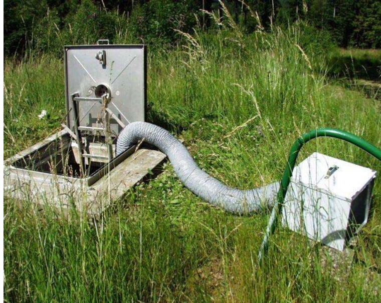
Abbildung 9.5: Mobiles Belüftungssystem mit Dieselstromaggregat für einen Quellschacht des Wasserversorgungsunternehmens Nr. 5322.
