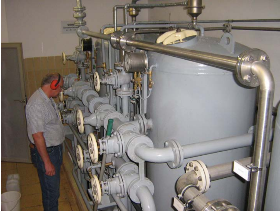
Abb. 10: Durchführung der Rückspülung mit Luft und Wasser
