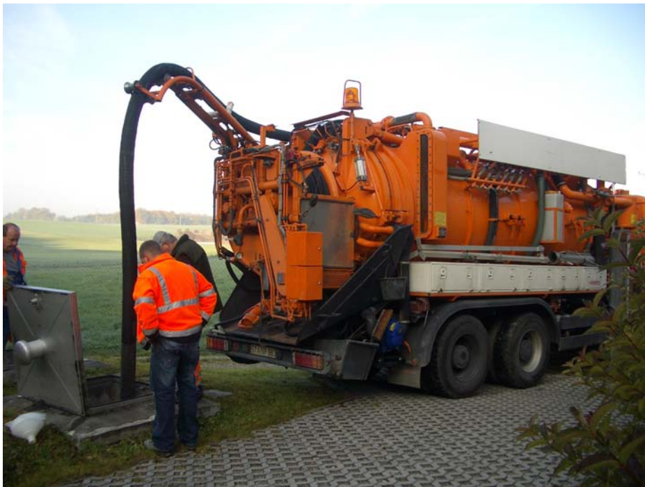
Abb. 22: Saugwagen zur Entleerung des Absetzbeckens
