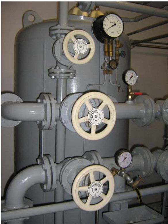
Abb. 9: Geschlossener Filterkessel zur Enteisung/Entmanganung
