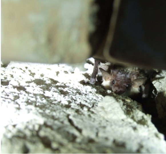
Abb. 54: Kirche Aresing: Ein Graues Langohr sitzt tief versteckt in einer Fuge im Mauerwerk des Kirchturms auf Höhe des Dachbodens.
