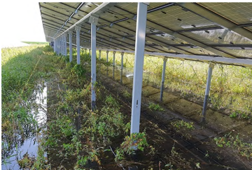
Abb. 25: 29.7.21, Ostrand des Nord- teils, Blick nach Osten; Pflützen mit lückiger Vege- tation unter Modulen
