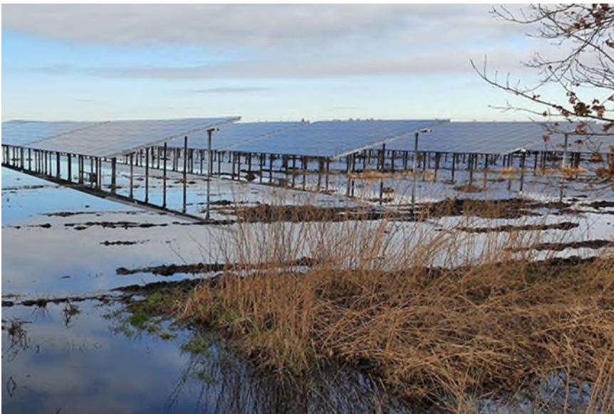
Abb. 29: 9.2.22 Nordteil mit Staubässe-Pfützen unter den Modulen
