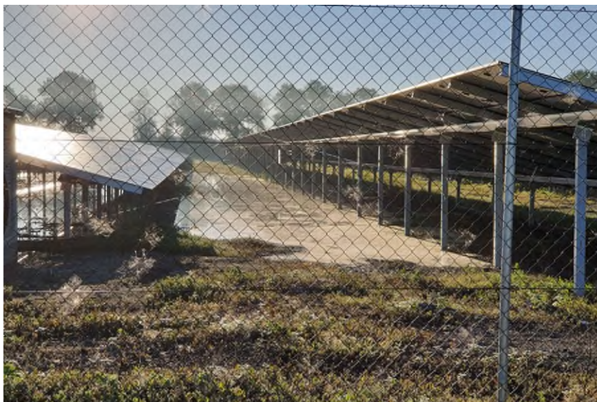
Abb. 19: 1.6.21 Nordteil, Blick nach Osten; Pfüten unter und zwischen Modulen
