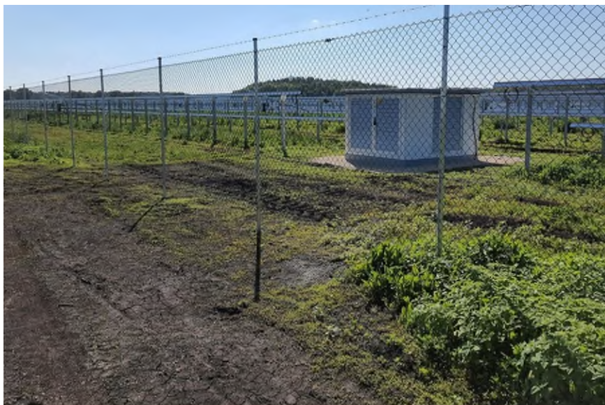
Abb. 37: 1.6.21, Nordrand des Süd- teils, Blick nach Südosten; Wechselrichter
