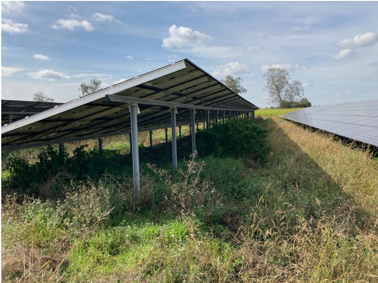
Abb. 2: PVA Schornhof, Teilfläche Nord. Zustand September 2021, Ruderalflur unter und zwischen den Photovoltaikpanelen
