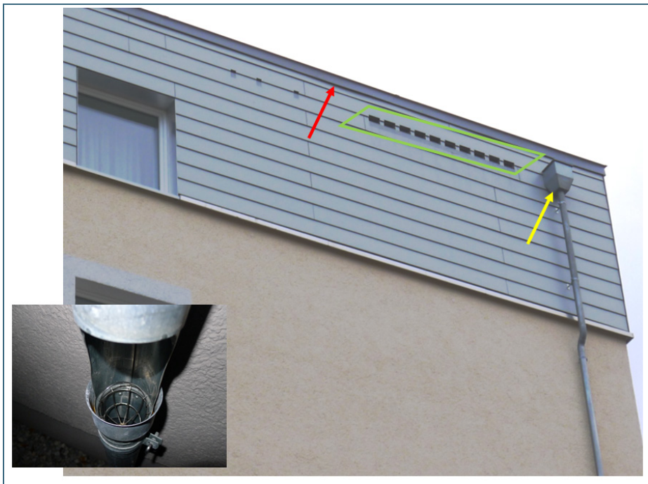
Abb. 27: Roter Pfeil: Spalt unter dem Dachrandblech, den Fledermäuse anfliegen; unterhalb des Blechs befinden sich die Einflugsöffnungen der Fledermausquartiere (grünes Rechteck), rechts daneben der Einlauftrichter (gelber Pfeil).
