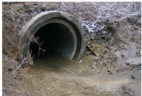
Abb. 51: „Überdimensionierter“ Rohrdurchlass an Quellabfluss im Lkr. Weiden i. d. OPf.
