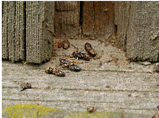
Abb. 8 (rechts): Kotpuren am Fuß der Fassade eines Hochhauses (Abendseglerquartier hinter Dachverblendung).
