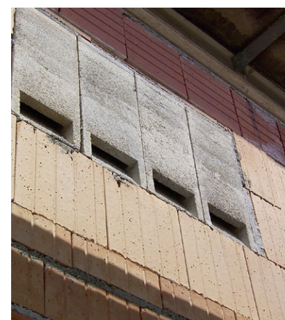
Abb. 42 (links): In den Giebel dieses Einfamilienhauses wurden zwei Fledermausquartiere eingebaut (siehe Beschreibung unten links).
