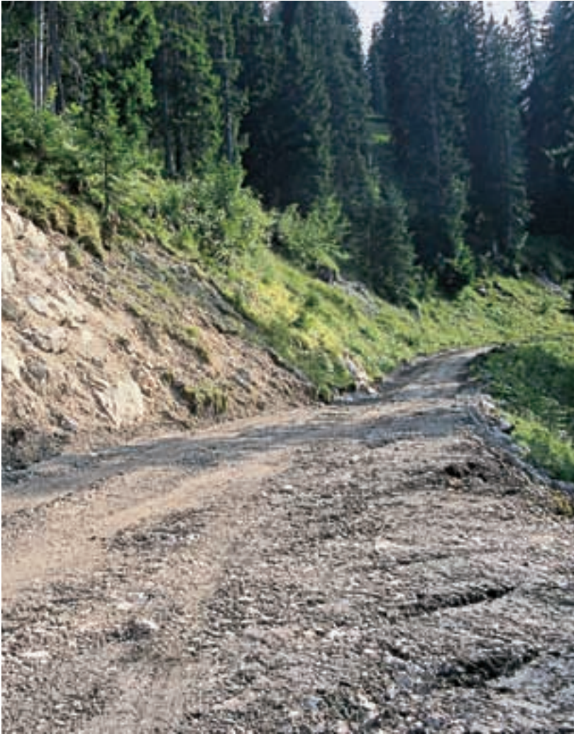
Foto 46: Am Übergang zwischen planierter Fläche und dem ursprünglichen Relief entsteht der sogenannte Hanganschnitt. Dieser ist oft instabil und muss, wie im Beispiel dargestellt, gesichert werden (GAP06 Alpspitz/Hausberg/Kreuzeck).
