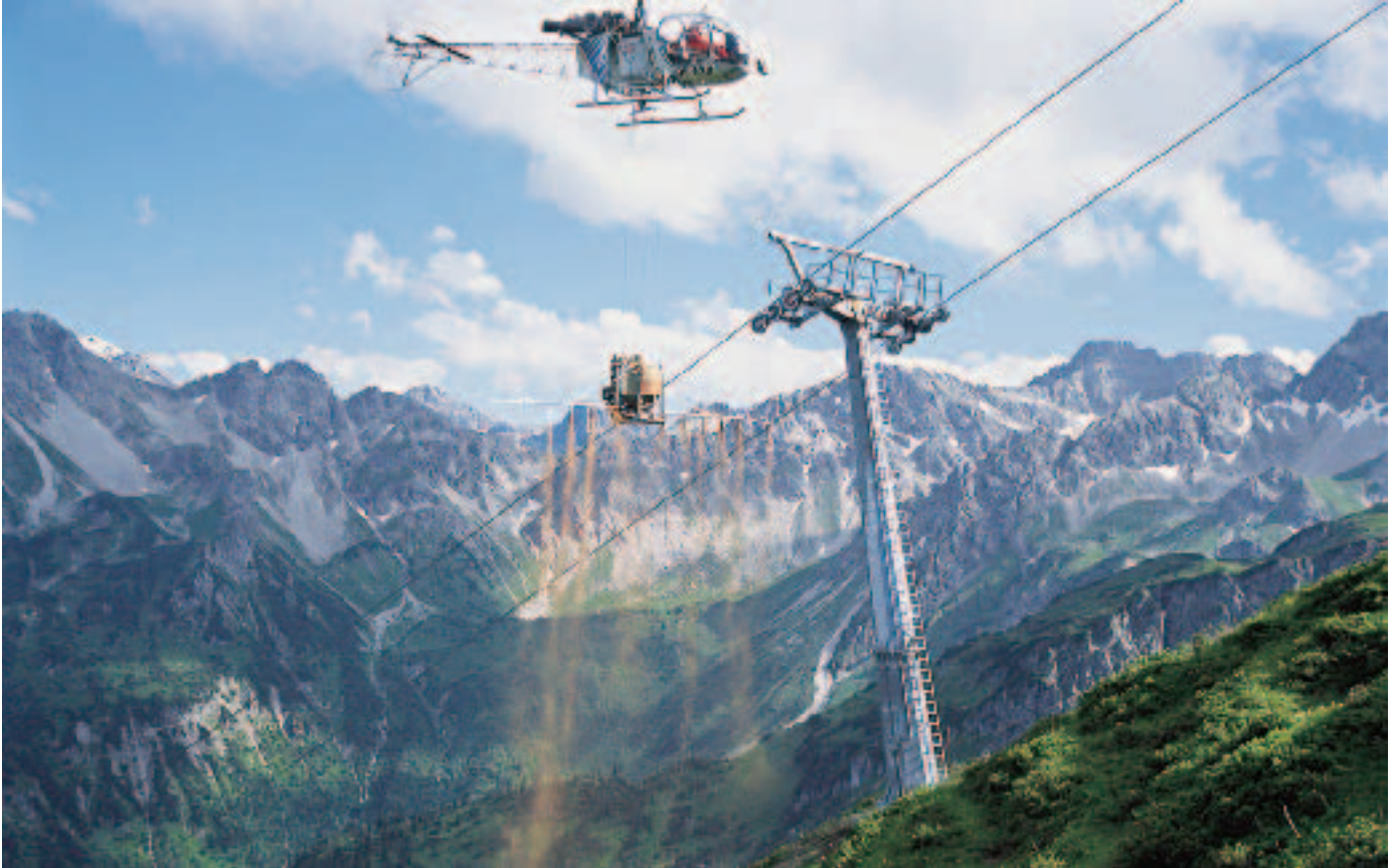
Foto 96: Beim Verfahren der Spritz-Begrünung wird eine flüssige Mischung aus Grassamen, Wasser und Dünger hergestellt und mit einem selbstzersetzenden Klebemittel verspritzt (OA16 Fellhorn).
