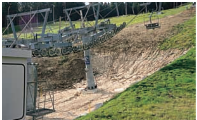
Foto 24: Talstation einer 3er-Sesselbahn (BGL04 Göttschen).
