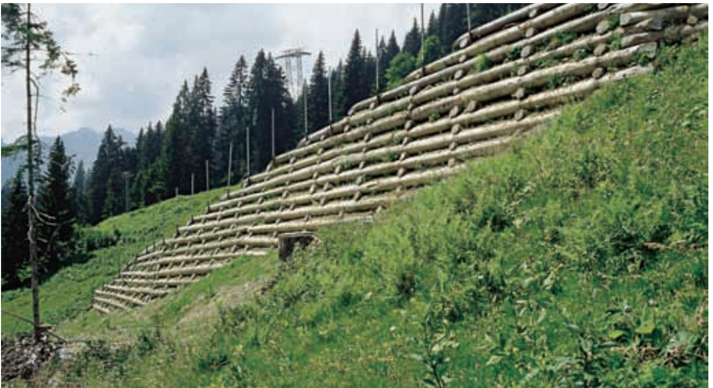
Foto 48: Hangsicherung/Stützwand (OA16 Fellhorn).
