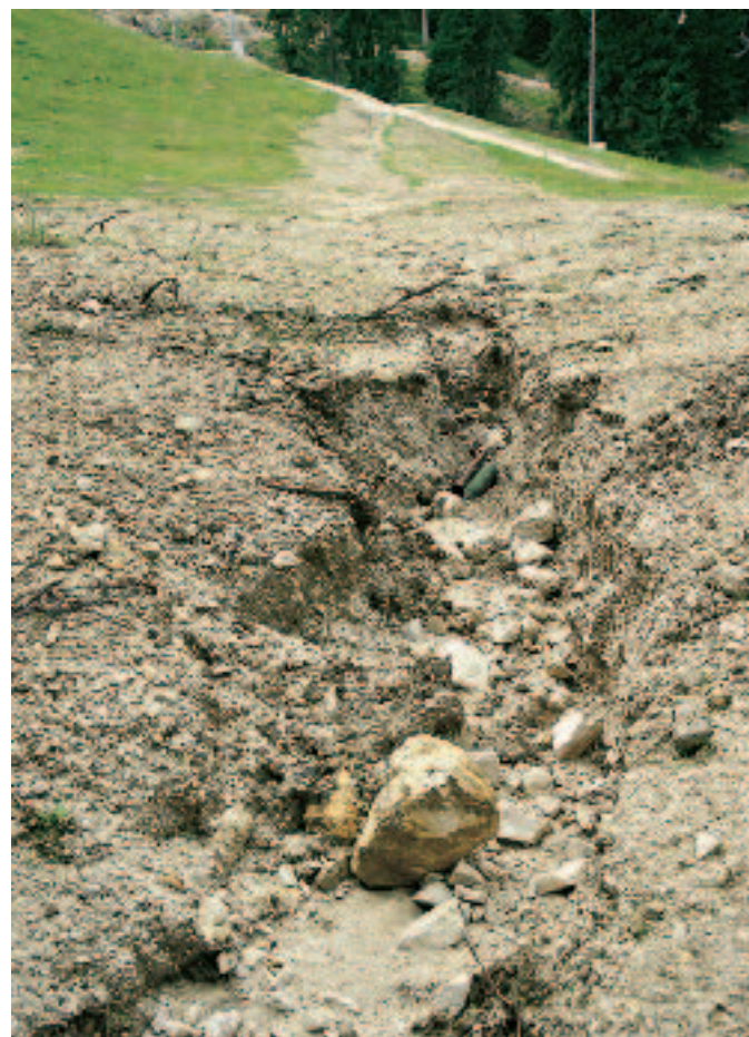
Foto 87: Im Hintergrund flächige Erosion, im Vordergrund Tiefenerosion.
