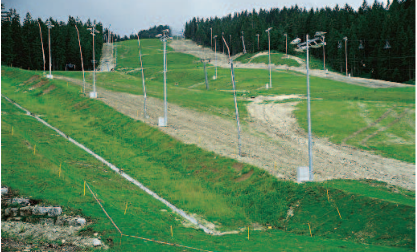
Foto 25: Ein Skigebiet im Bau: Links Halfpipe mit Beleuchtung und Beschallung, rechts Abfahrtspisten mit Beschneigungsanlage (BGL04 Göttschen).
