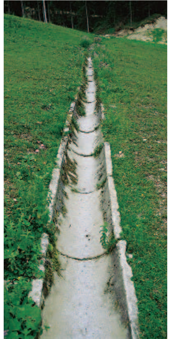
Foto 47: Befestigter Drainagegraben (BGL04 Göttschen).
