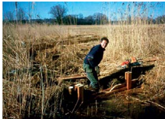
Abbildung 26: Anstau einer Flutmulde (Grabenstatter Moos TS). Ziel der Maßnahme ist es, wieder Nassstandorte für Watvögel zu entwickeln (Foto R. STROHWASSER).
