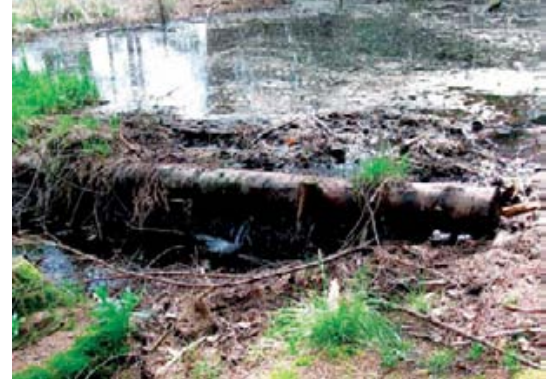
Abbildung 39: Undichter Damm. Rundholzkonstruktion ohne Dichtung und mit nur schwacher und einseitiger Torfhinterfüllung.
