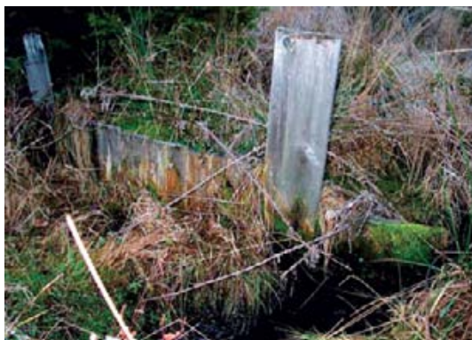
Abbildung 38: Umspülter Damm mit Nut-Feder-Brettern. Zur Vermeidung sind Überläufe vorzusehen, ohne Torfummantelung verwittern die Bretter relativ rasch.
